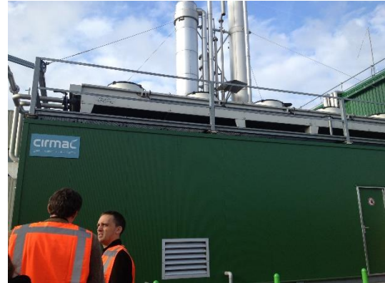
メタンガス精製装置
